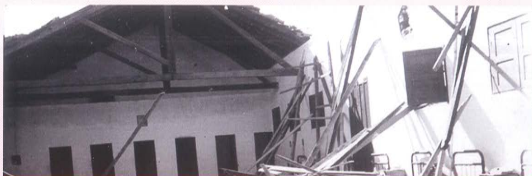
Caída del techo del INTERNADO del Colegio de Dianópolis
